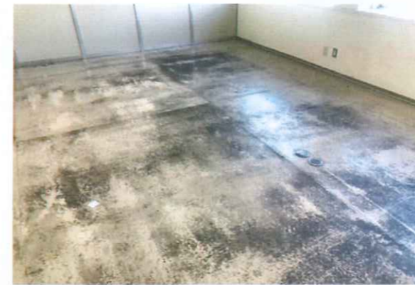
作業前:汚れが真っ黒です
