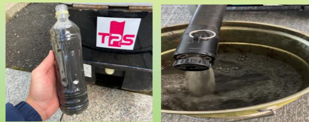
施行後回収汚水①
